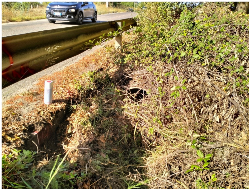
Foto 4: Tubazione scarico acque bianche zona P.I.P. nella cunetta in terra.
